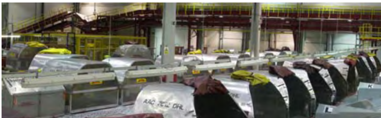
DHL Vitoria in Spanje, geautomatiseerd door Dolmen IP
